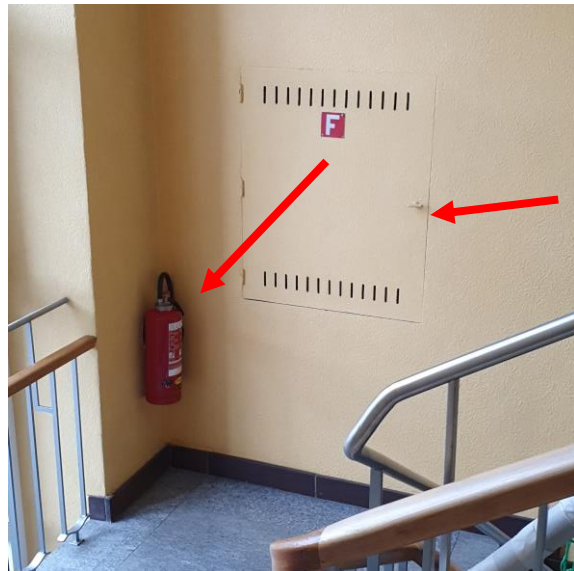
Feuerlöschposten Treppenhaus 1. – 2- OG
